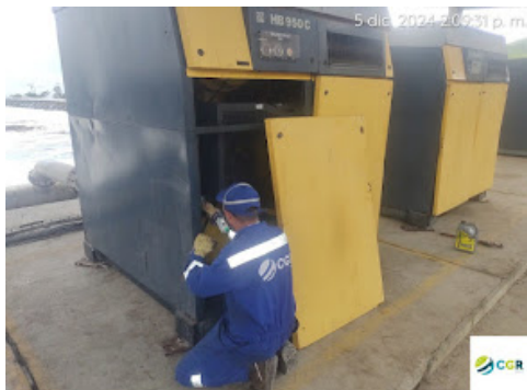
Mantenimiento de equipos Kaeser
