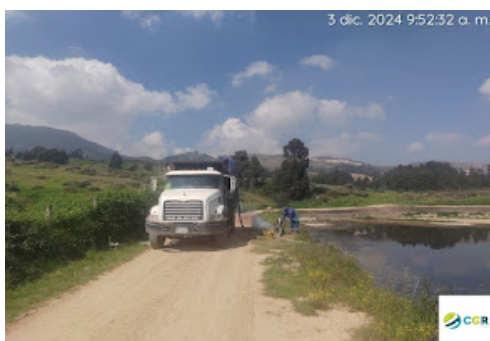
Retiro de lixiviados de cantera eterna
