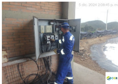
Revisión de tableros electricos
