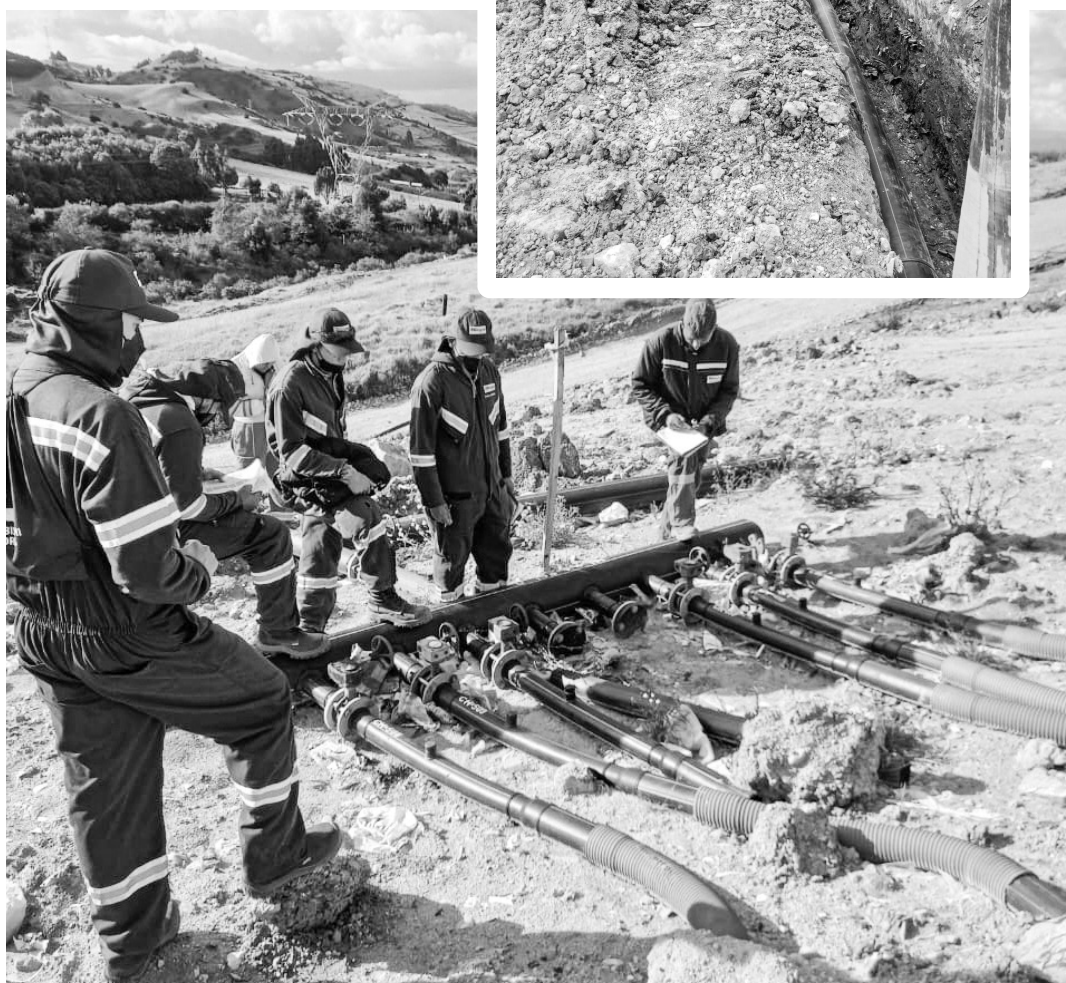
► Imágenes planta Biogás Colombia y campo de gas.
